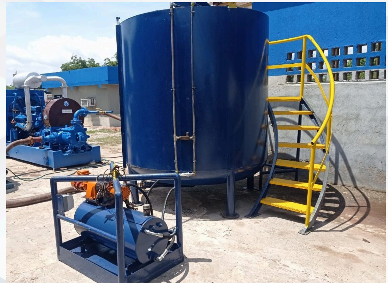
Conjunto en sitio: tanque, agitador y unidad de bombeo.
